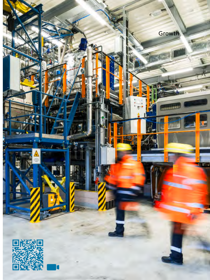
Ein Blick in die selbstentwickelte Demoanlage am Standort in Hamburg.
